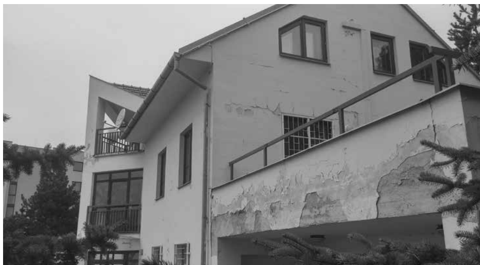
Pohled od východu na garáže a vstup. Právě garáž, respektive zatékající terasa nad ní, nám dělá velké starosti.
